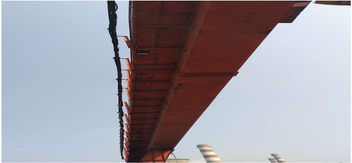
运输处型钢成品组中间库 2#龙门吊车体悬臂现状
